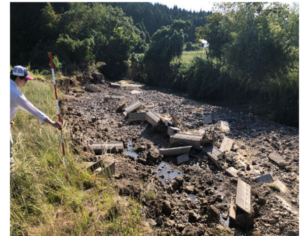
水路の破損(石川県珠洲市)
