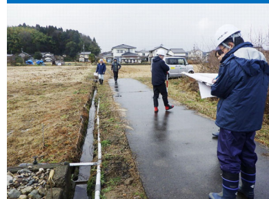
農業用水路の被災状況を調査
