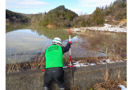
ダム堤体に発生した段差の調査
