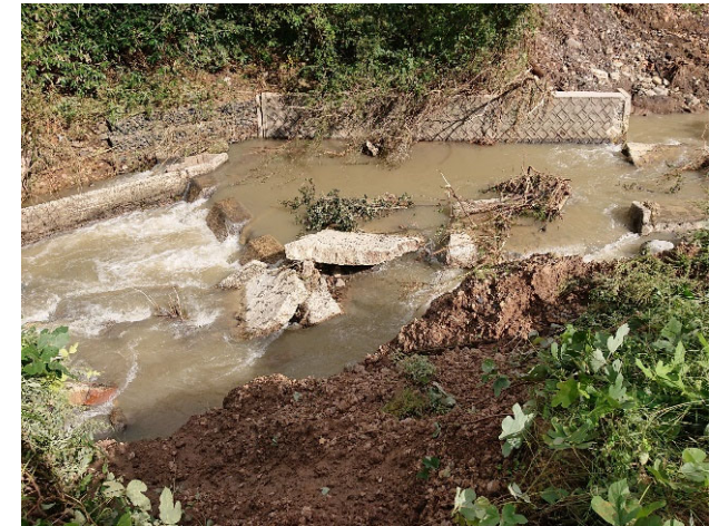
頭首工の崩壊(石川県能登町)
