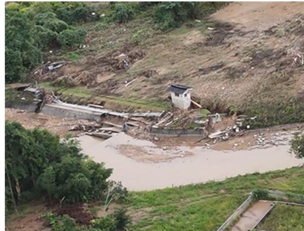
取水路埋塞及び操作室周辺の崩壊 (石川県珠洲市)
