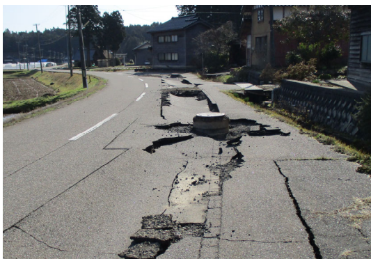
マンホールの隆起
