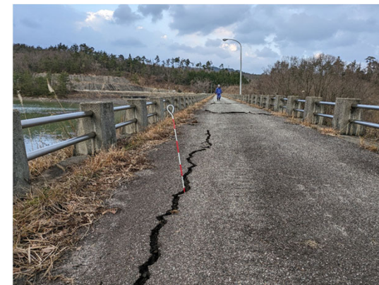
ダム堤体のひび割れ(寺家ダム)
